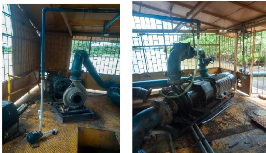
REGISTRO FOTOGRÁFICO 4. SISTEMA DE BOMBEO DE LA BOCATOMA DEL ACUEDUCTO REGIONAL MANATÍ – CANDELARIA. FECHA: 16 DE MAYO DE 2023.
