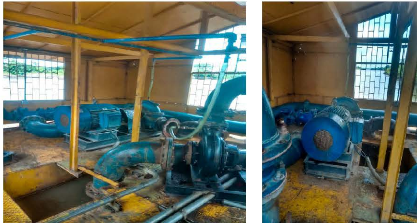
REGISTRO FOTOGRÁFICO 3. SISTEMA DE BOMBEO DE LA BOCATOMA DEL ACUEDUCTO REGIONAL MANATÍ – CANDELARIA. FECHA: 16 DE MAYO DE 2023.
